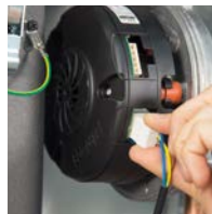
Disconnessione elettrica ventilatore
