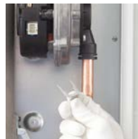
Sblocco tubo gas
